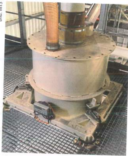
Die Behälterwaage verwiegt batchweise den Quarzsand.
